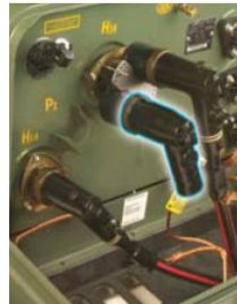
Figura N° 13. Pararrayo tipo codo para cable subterráneo instalado sobre el pasamuro de un transformador.
